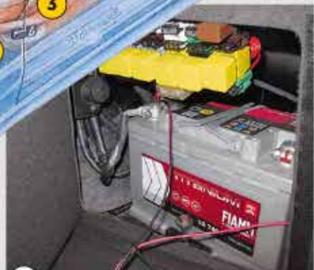
6 Ein Check des Batteriefachs auf säurebedingte Korrosion schadet nicht
